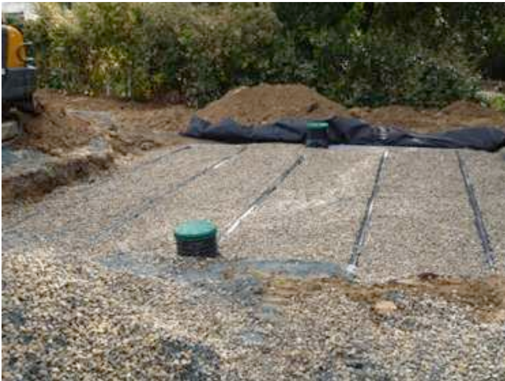
Illustration 5 : Photographie d'une installation achevée et faisant l'objet d'un contrôle de conception (Var) Source : ROLLIN J., 2012.
