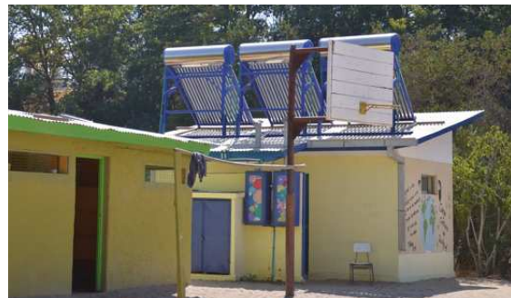
Photographie 15: Chauffe-eau solaire, Ecole Santiago Bueras, RB La Campana-Penuelas
