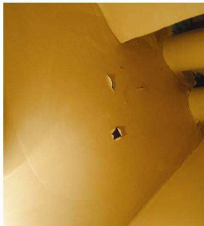
Des stigmates de problème d'étanchéité
