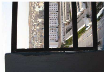
Des barreaux mal fixés
