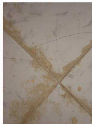
Carrelage mal posé, rapidement cassé
