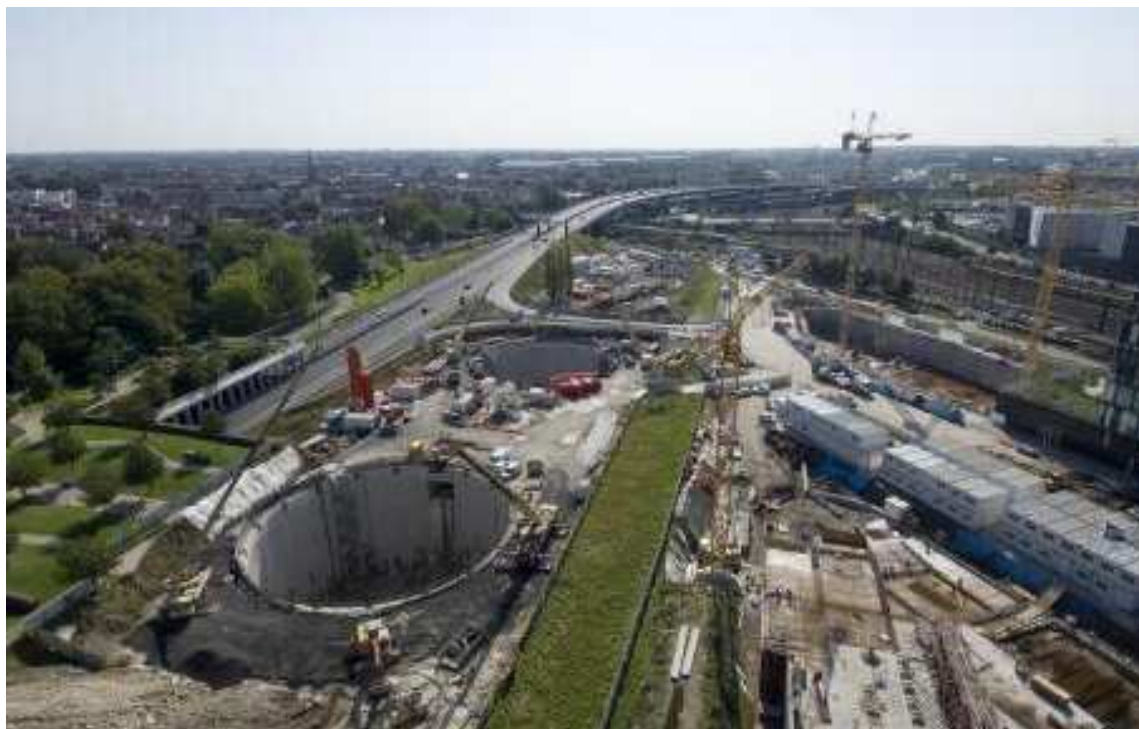
Figure 1 : bassins de stockage des eaux pluviales en construction à Lille – Fives, image Lille Métropole
