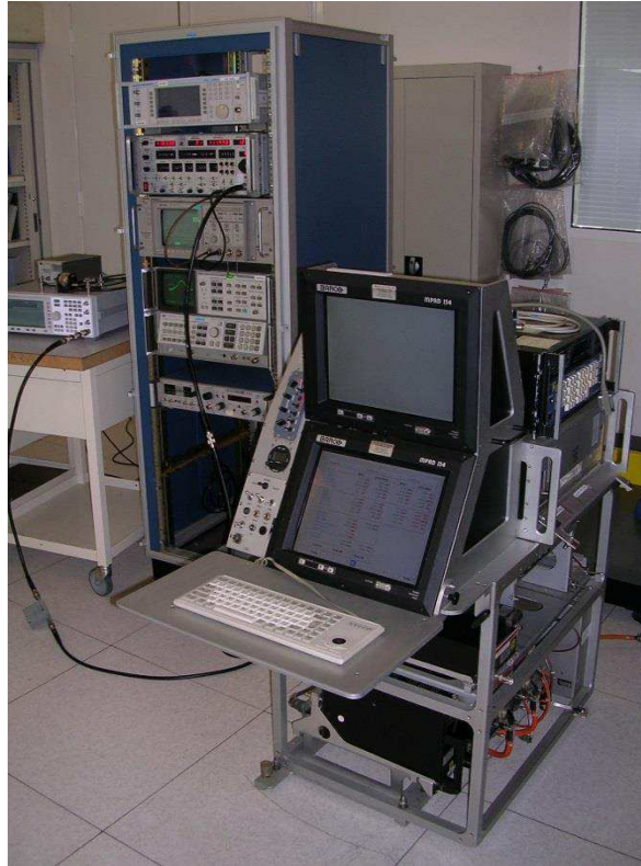
Figure 2-24 Banc de test utilisé au STNA comprenant les systèmes d'avionique et le générateur JTIDS/MIDS.
