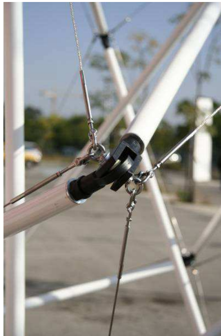
Figure 67. Vue d'un nœud laissant apparaître des jeux importants, générateurs de flexions parasites
