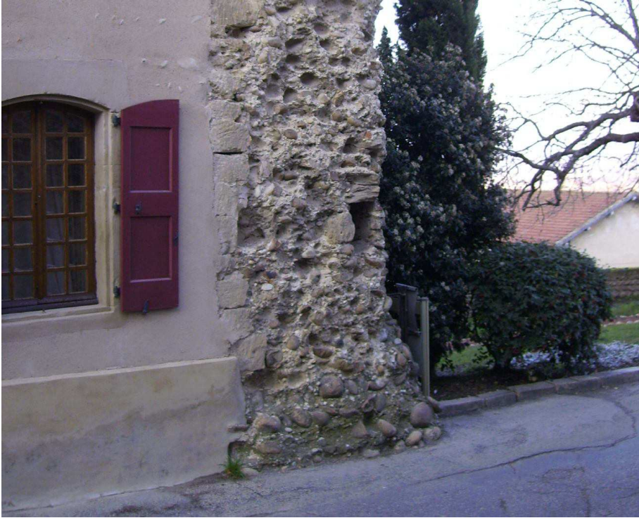
Doc. 68. Trou barrier servant à fermer la porte Salmone
