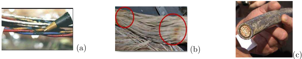
Figure I.6 – Différents types de vieillissement : a) Contamination chimique. b) Vieillesse thermique. c) Corrosion.
