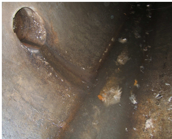
FIGURE 6.5 – Mauvais raccordement des canalisations d’eaux usées au réseau d’eaux pluviales drainant la partie ouest du bassin versant des Grands Gohards
