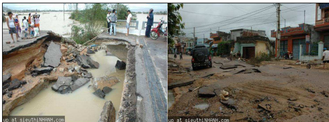
Photographie 6.3. Dégâts sur les voies de communication dans les districts de Nhon Binh et de Dong Da à Quy Nhon (4 novembre 2009)
