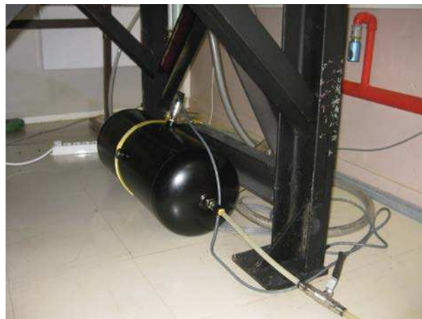
FIGURE 2.4 – Le réservoir tampon et son capteur de pression.
