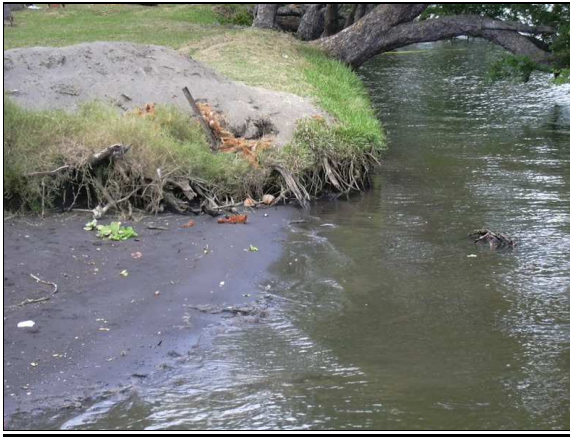
Photographie 18 : Erosion des berges de l'Etang Saint Paul (Réunion)
