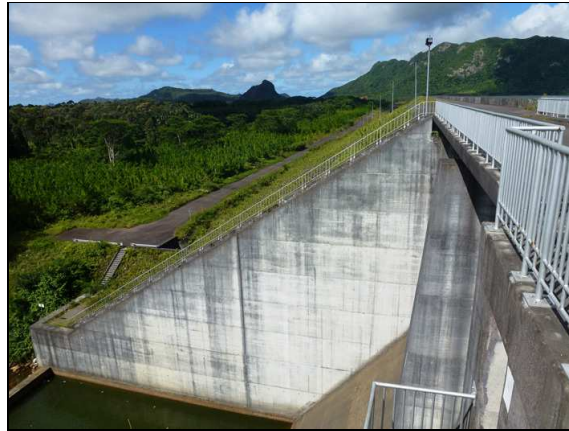
Photographie 55 : Le réservoir des Midlands (Maurice), l'exemple d'un réservoir moderne
