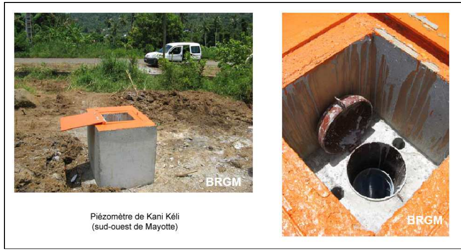
Figure 44 : Piezomètre de Kani Kéli (sud-ouest de Mayotte)
