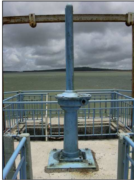
Photographie 21 : Exemple de pelle de vidange Cliché Mathelin, 2011
