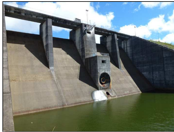
Photographie 23 : Déversoir de surface et de crue du réservoir des Midlands (Maurice)
