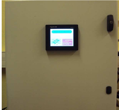
Figure 47 : Armoire électrique alimentant le dispositif
