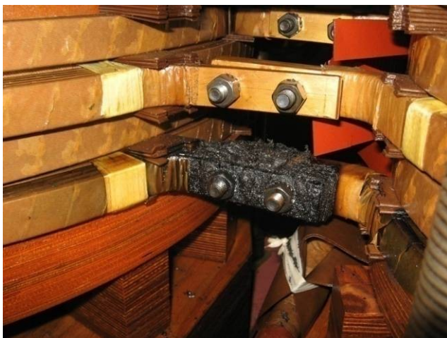
Figure 21 : Point chaud sur connexion boulonnée
