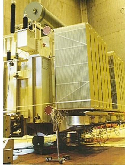
Figure 13 : Radiateurs sur un transformateur
