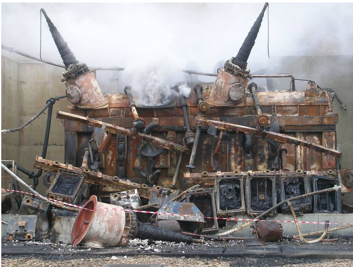
Figure 18 : Explosion de transformateur
