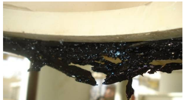
Figure 25 : Joint de traversée écrasé
