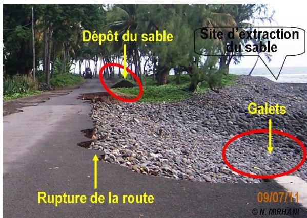
Photo 63- Apparition des galets et rupture de la route près d'un site d'extraction de sable marin à Pomoni
