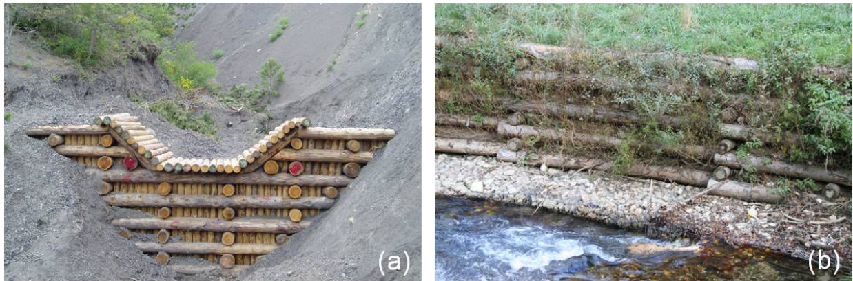
Figure 92 – Exemples d’ouvrages de génie écologique : (a) seuils en bois destinés à limiter l’érosion dans les ravines marneuses, (b) caissons végétalisés destinés à stabiliser les berges d’une rivière (clichés F. Rey, 2003 et 2007)
