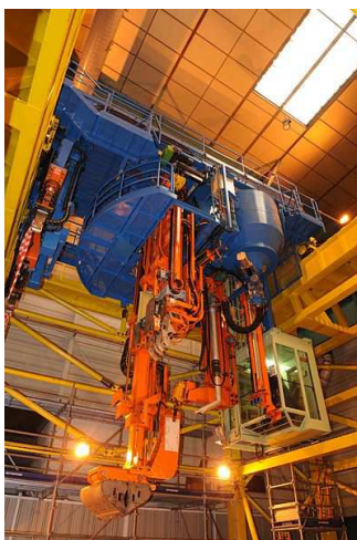
Figure 24 : Pont roulant (MSE) équipé d'une cabine climatisée
