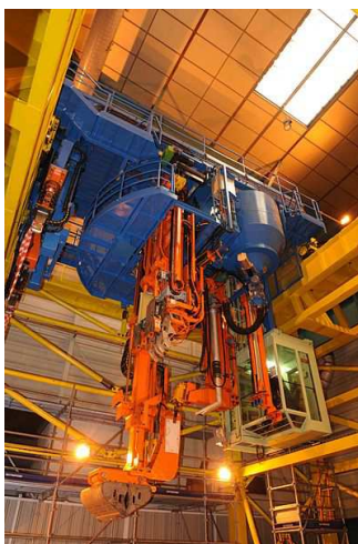
Figure 24 : Pont roulant (MSE) équipé d'une cabine climatisée
