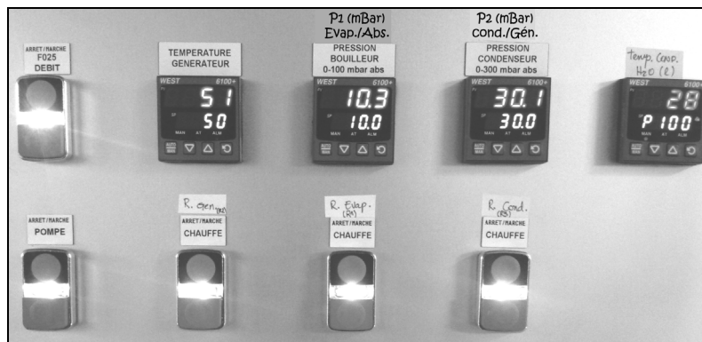
Figure Annexe 3. Photo de l'armoire électrique et disposition des régulateurs de la machine à absorption. P1 représente la pression dans l'évaporateur/absorbeur et P2 la pression dans le condenseur/générateur.
