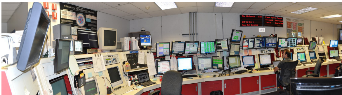
Figure 4.6: Vue panoramique de la salle de contrôle de DØ.
