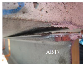
Rupture de AB17 par cisaillement du béton
