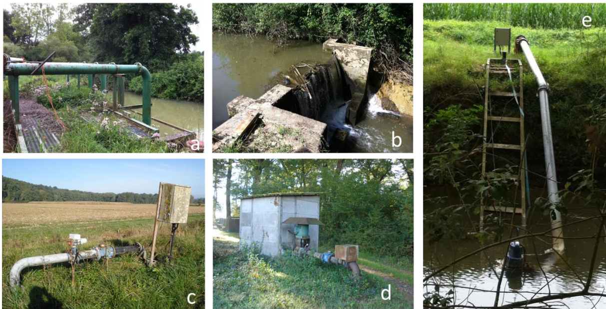
Figure 1-18 : Photos des différents ouvrages destinés à l'irrigation dans la région d'Audignon. a. pompes de prélèvement dans le Laudon, b. systèmes de batardeaux pour augmenter le niveau dans le Laudon, c. et d. forages agricoles d'Eyres-Moncube (Crétacé), e. pompe immergée dans le Gabas
