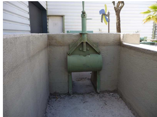
(b) Détail d'une vanne siphonnante sur grand canal
