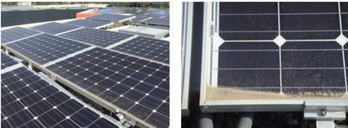
Figure III- 20: Salissure sur module PV situé sur le toit "R+2" du bâtiment ADREAM
