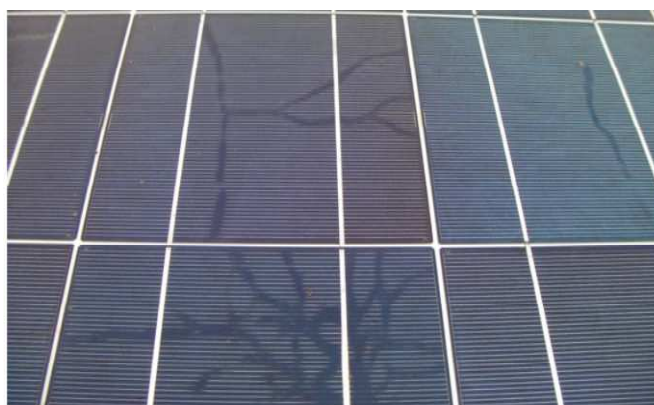
Figure III- 25: formation de traces noires ("snail trail") sur la feuille d'encapsulation des cellules PV
