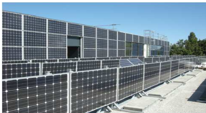
Figure II- 7: Toiture expérimentale 35 kWc, ADREAM
