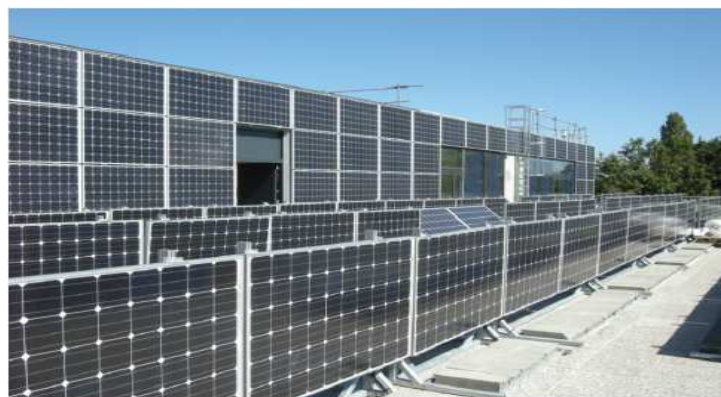
Figure II- 7: Toiture expérimentale 35 kWc, ADREAM
