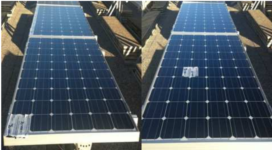
Figure IV- 6: Tests expérimentaux avec défauts sur les modules PV TENESOL
