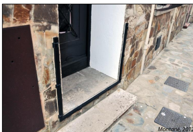
Photographie 3 : Glissières synonymes de l'utilisation d'un batardeau en cas de crue (Collioure, 66)
