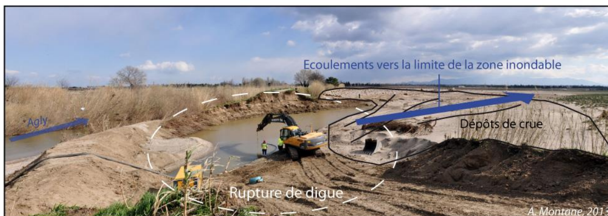
Photographie 13 : Rupture de la digue de l'Agly, sur la commune de Pia en mars 2013
