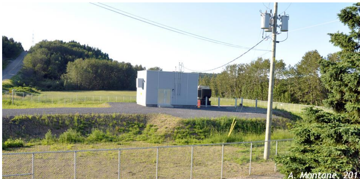
Photographie 18 : Transformateur électrique surélevé dans le lit majeur de la Matane
