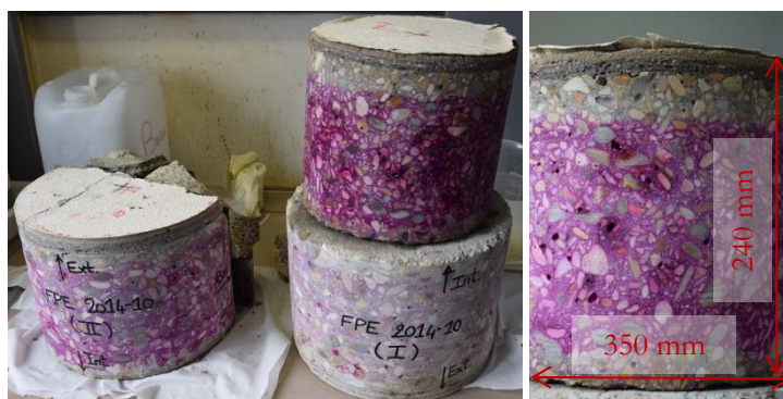
Figure 38 : Carottes de béton, à base de ciment Portland, prélevés sur le bâtiment 158 du CEA Saclay – Mise en évidence de la zone carbonatée.
