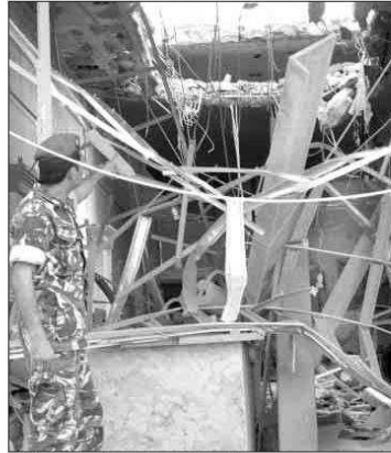
Un bâtiment totalement dévasté à Kfaym par une bombe israélienne.
