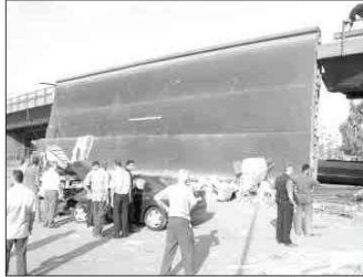
L'effet collatéral des bombardements d'Izar : cette portion de pont semble avoir été coupée au avion.
