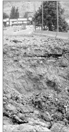
Les dommages causés à une route à quelques kilomètres de la frontière syrienne, dans le Liban.
