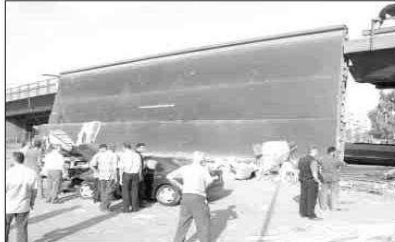
L'effet collatéral des bombardements d'hier : cette portion de pont semble avoir été coupée au niveau.
