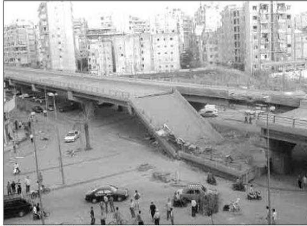
À la Faïra de la banlieue sud, le pont menant à l'aéroport Rafic Hariri touché de plein fouet par l'aviation israélienne.
