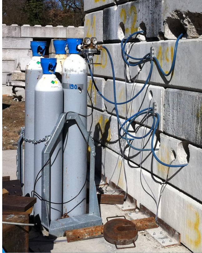
Figure 57 : photo des réservoirs d'oxygène sous pression
