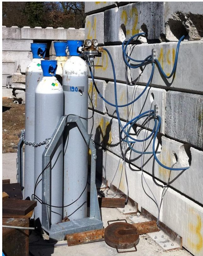
Figure C.F11 : photo des réservoirs d'oxygène sous pression
