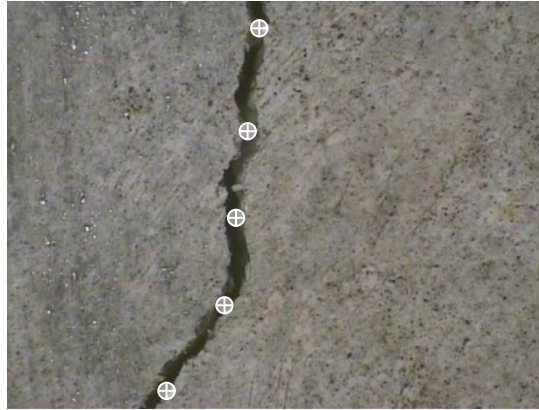
Figure III-30 : Contrôle de l'ouverture de fissure sur une face au niveau des aciers tendus.
