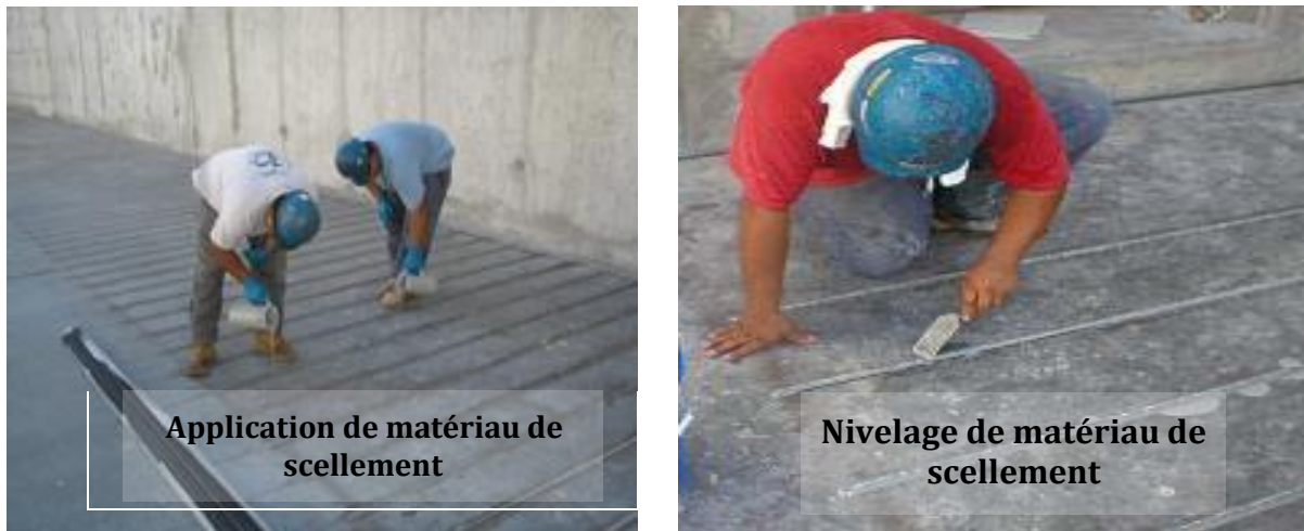
Figure I-10 : Procédures du renforcement d'un nouveau réservoir d'eau en utilisant de la technique NSM avec des joncs en fibre de carbone CFRP (SPS Structural Preservation Systems s. d.).
