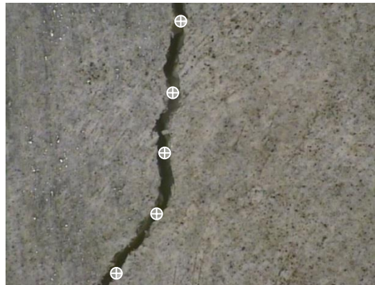
Figure III-30 : Contrôle de l'ouverture de fissure sur une face au niveau des aciers tendus.
