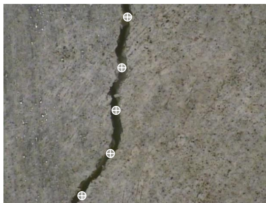
Figure III-30 : Contrôle de l'ouverture de fissure sur une face au niveau des aciers tendus.
