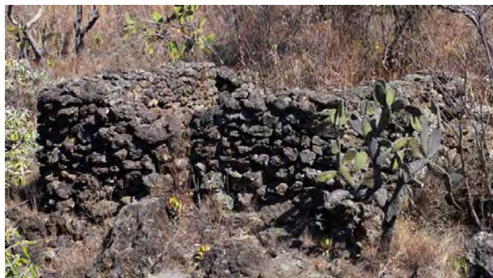
Figure 48 : Exemple d'un édifice cellulaire aux murs faits de pierres anguleuses. Les pierres sont relativement calibrées, mais très peu travaillées. Peu de mortier est resté en place.
