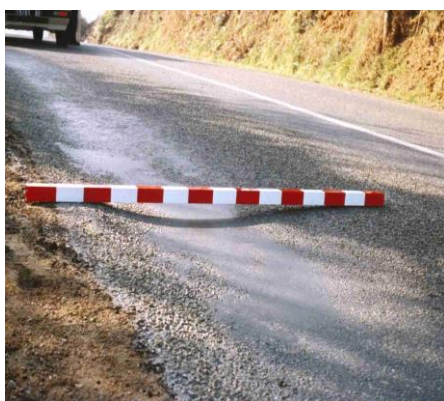
Figure I.3. Orniérage de la chaussée
