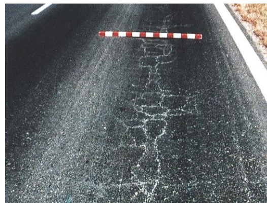
Figure I.4. Fissuration de la chaussée
