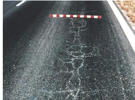
Figure I.4. Fissuration de la chaussée
