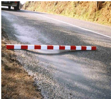
Figure I.3. Orniérage de la chaussée
