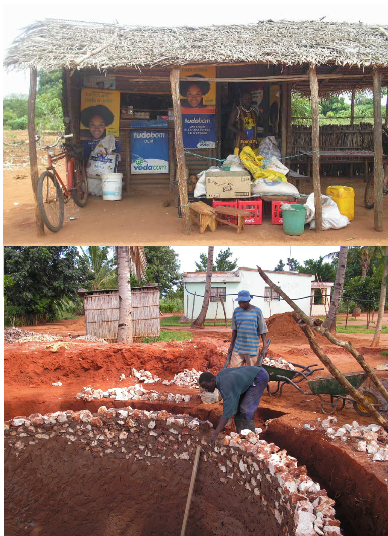
Photos 6 et 7 : construction d'un réservoir d'eau réalisé par un ménage avec stratégie de type 3 pour une famille de type 4 (bas) et boutique de commerce de produits de base (haut).
