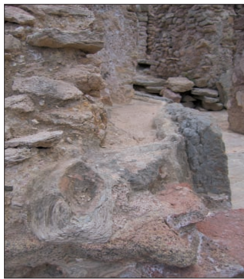
Figure B.90. Canalisation à l'air libre provenant de T7 et alimentant la salle T6 en eau thermale lors de l'état 5.
