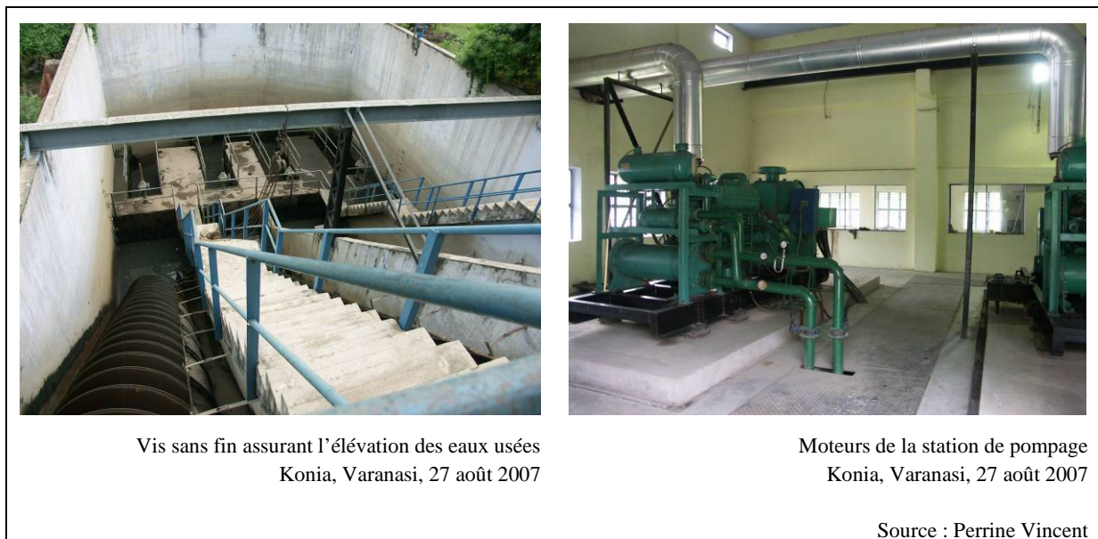
Photographie 19 – station de pompage principale
