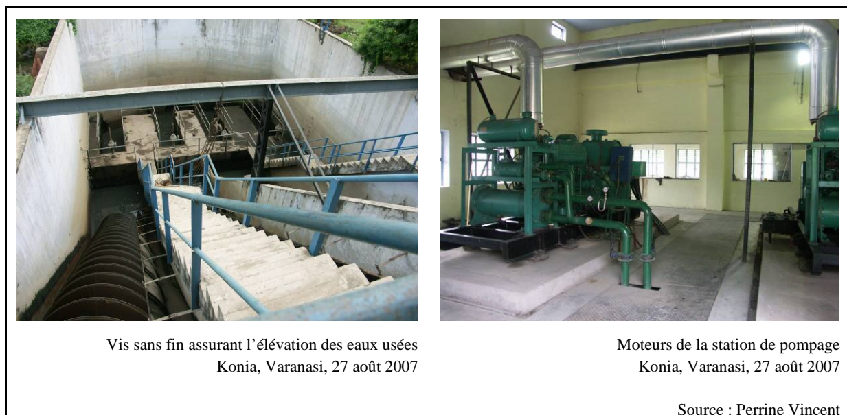
Photographie 19 – station de pompage principale
