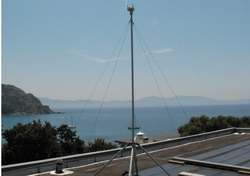
FIGURE 3.6 – Mât météorologique sur le toit du bâtiment Charpak
