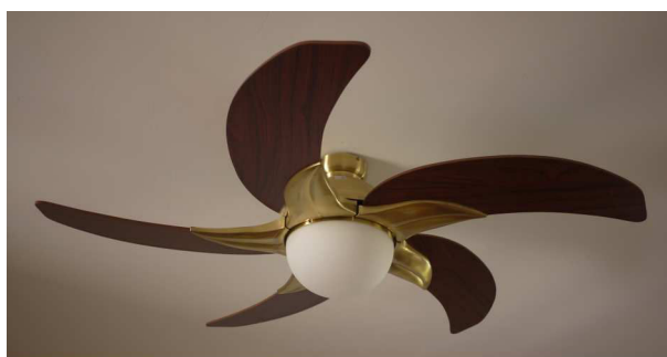
FIGURE 3.5 – Brasseur d'air du bâtiment Charpak
