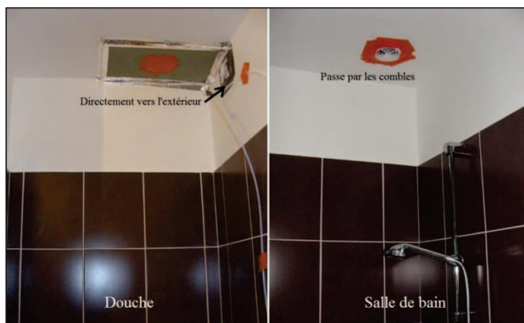
Figure III.9 – L'évacuation de la VMI-R dans les toilettes
