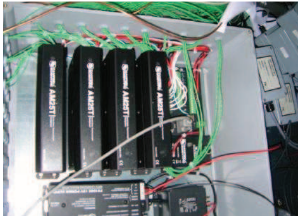
Figure II.32 – Centrale d'acquisition et multiplexeurs
