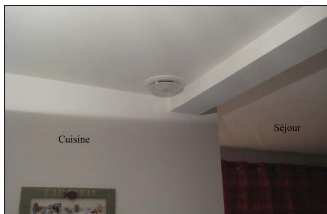
Figure III.10 – La bouche d'insufflation au rez-de-chaussée
