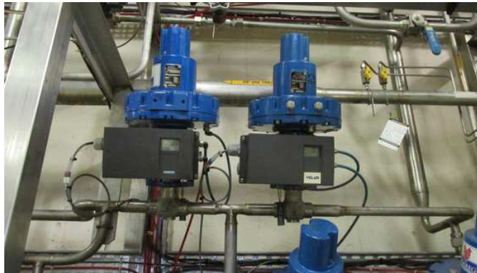
FIGURE 2.8 – Vannes d'apport et de retrait de gaz de la station de compression du SBT avec leur positionneur et actionneur pneumatique
