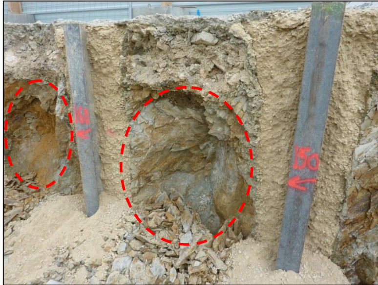
Figure 2.3 Eboulement de terrain entre les profilés d'une paroi berlinoise (source : Groupe Dacquin), Chantier Le Florilège, 2012 (Rennes)
