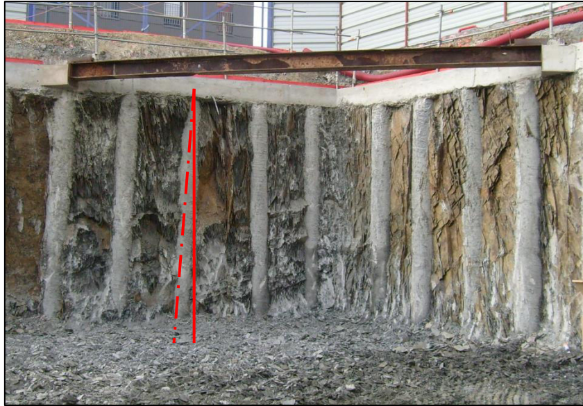
Figure 2.1. Déviation d'un pieu dans le plan d'une paroi de pieux distants (source : Groupe Dacquin). Chantier Siège Archipel Habitat, 2011 (sud de Rennes)
