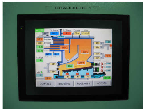
(a) Tableau de bord de la chaufferie à plaquettes de Vénissieux – Antoine Tabourdeau, 2012
