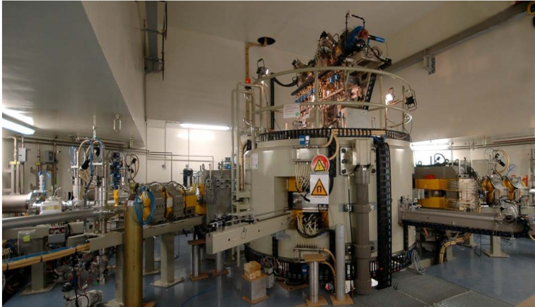
Figure 1.3- Photographie du cyclotron C70 ARRONAX dans sa casemate
