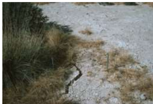
Figure 36 Vue d'une bordure de contraction végétale (à gauche) avec fente de dessiccation (milieu) et croûtes salines. (Crédit Grunberger O.)
