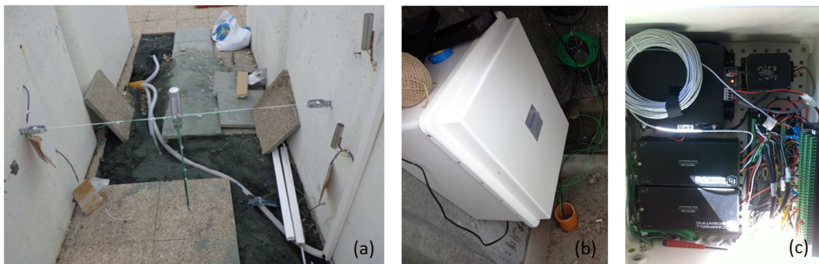
Figure 3-8 : Acheminement (a) souterrain des câbles de capteurs vers la centrale d'acquisition (c) placée dans un boîtier étanche (b) à l'intérieur d'un bloc du bâtiment central
