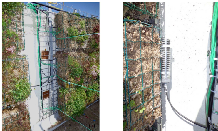
Figure 3-9 : Positionnement (a) des thermocouples, des capteurs de flux thermique et (b) de l'hygromètre dans le système du mur végétal
