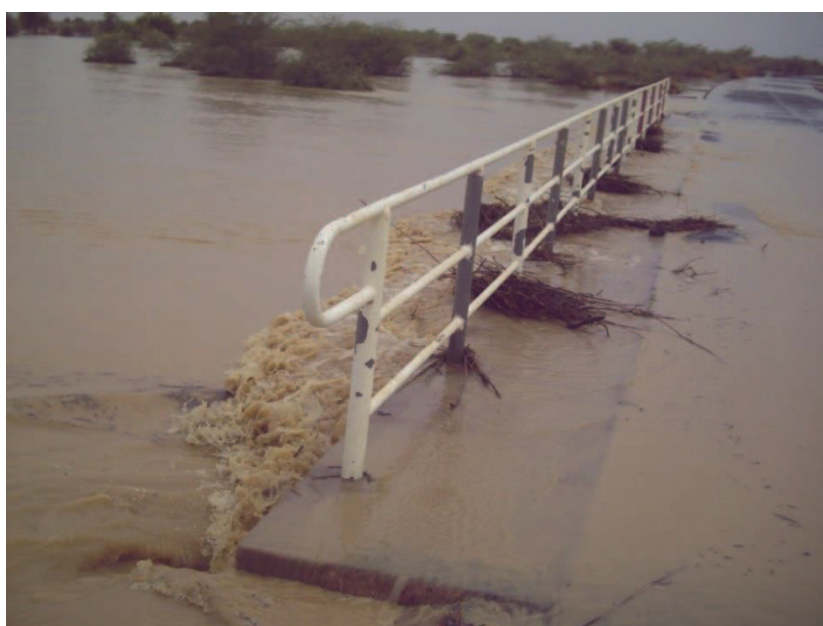
Photo 35 : La traversée du pont devient difficile en période de crue exceptionnelle
